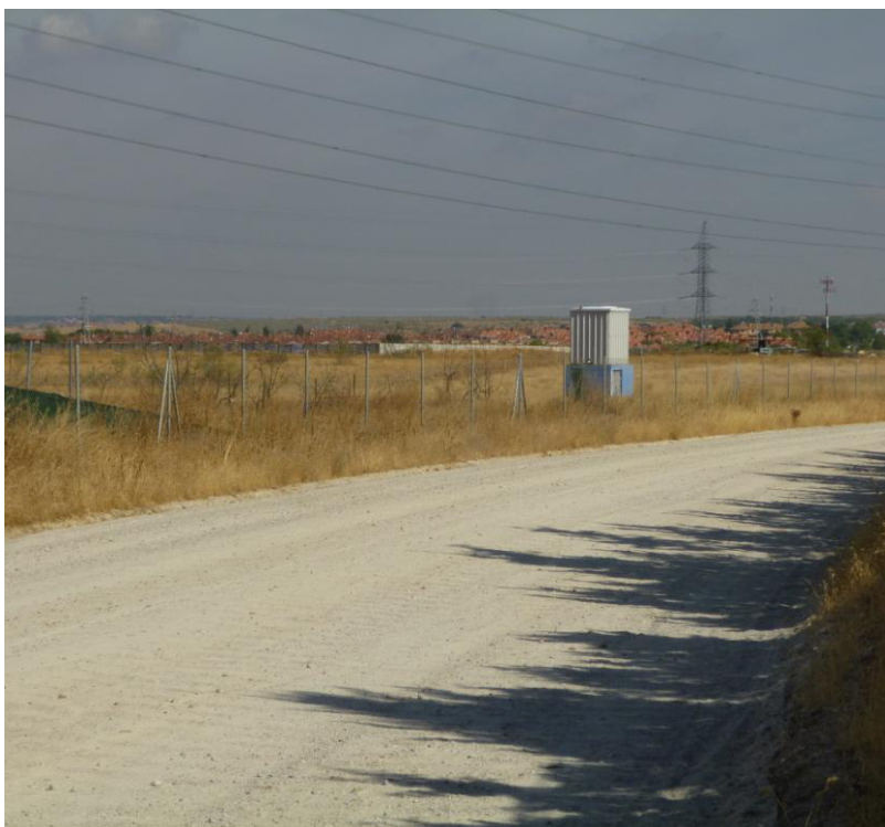
Foto 11. Pozo ubicado en la zona de la Alternativa 2. Caseta donde se ubican las bombas
